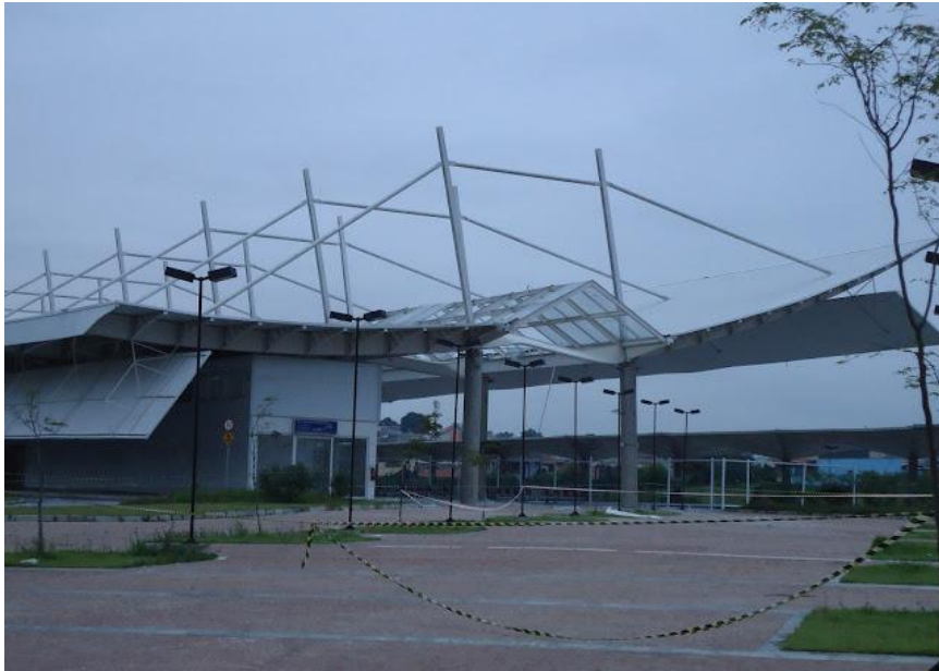
Figura.4.24. Tipos de eventos de tempo severo do sistema convectivo de 27 de março de 2012, ventos fortes provocaram queda do telhado no Terminal rodoviário de Guarulhos. Fonte: Jonas Pereira-Blog (2012).
