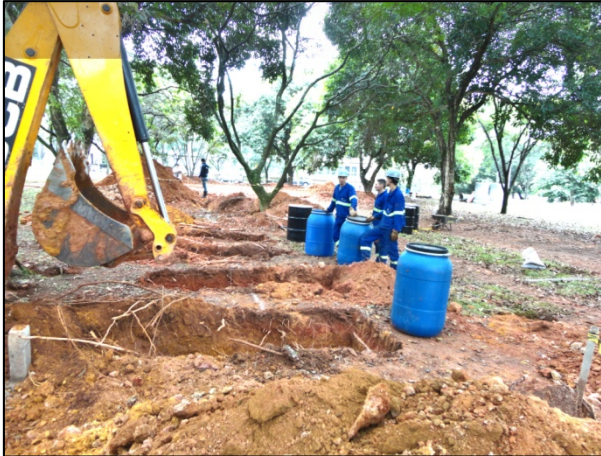
Figura 3.2. Retroescavadeira utilizada para a abertura das valas nas linhas 1, 2 e 3 do SCGR-II.
